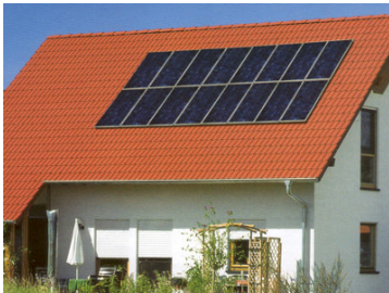
Fig. 4 : Panneaux solaires montés sur toiture.
