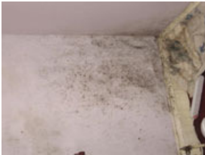
Bild 2: Schimmelbildung an Wänden und Decke durch schlechte thermische Isolation.
