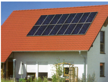
Bild 4: Solarzellen auf Dach.
